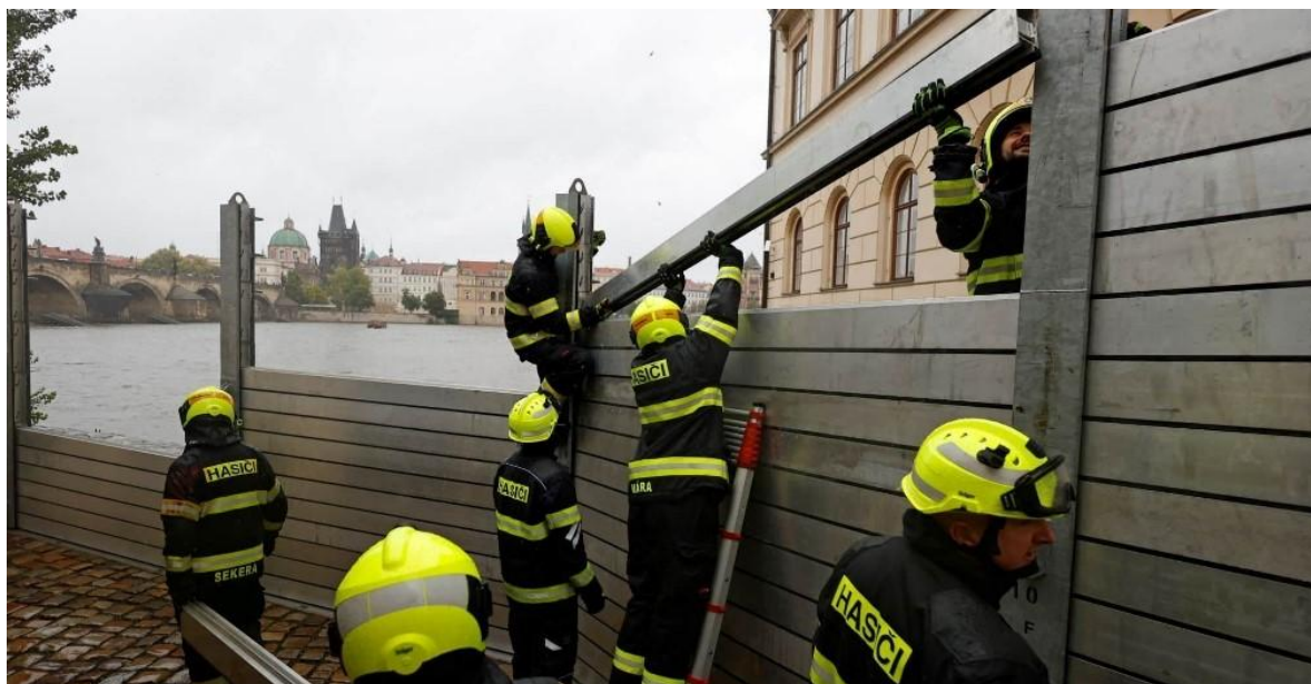
Foto 8 – mobilní protipovodňové stěny, Praha 2024
