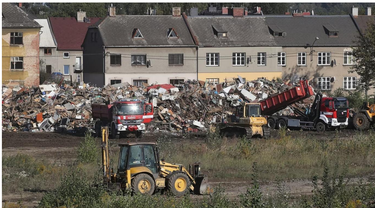
Foto 17 – úklid a vznikající skládka po povodni, Krnov 2024
